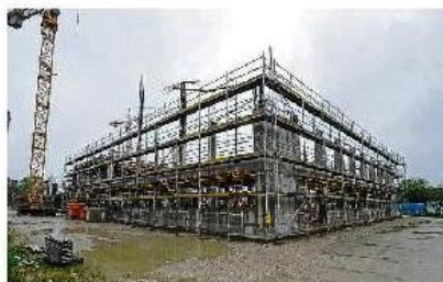
Kurz nach dem Baustart war Schluss: Weil die Griechen Fristen verstreichen ließen, holte sich die Stadt das Grundstück zurück. Nun tobt ein Streit um die Ruine. 109
