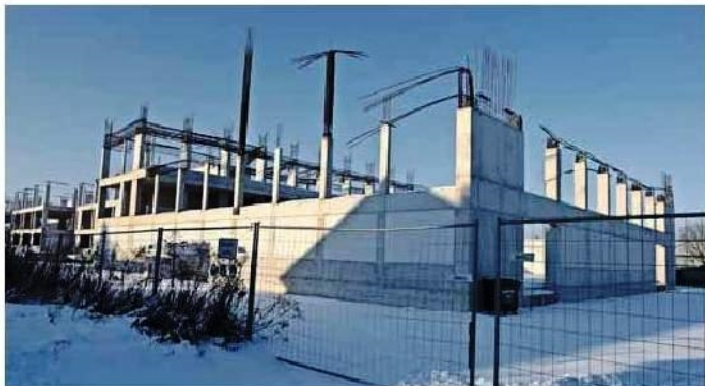
Ein halbfertiger Rohbau mit ungewisser Zukunft: die Baustelle der griechischen Schule von Berg am Laim. FOTO: CATHERINA HEISS
